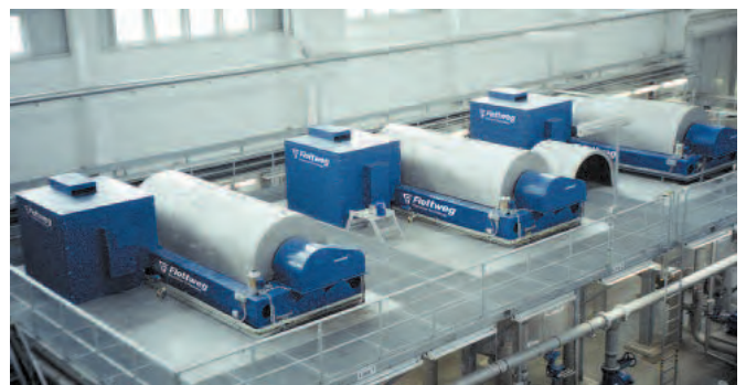
FLOTTWEG DECANTER Typ Z92 in einer deutschen Kläranlage
