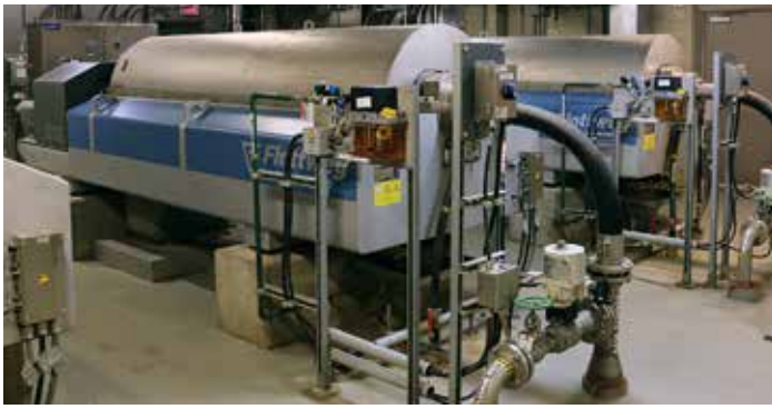
Seitdem die Flottweg Zentrifugen im Einsatz sind, spart die Kläranlage in Kanada jährlich circa 700.000 Dollar
