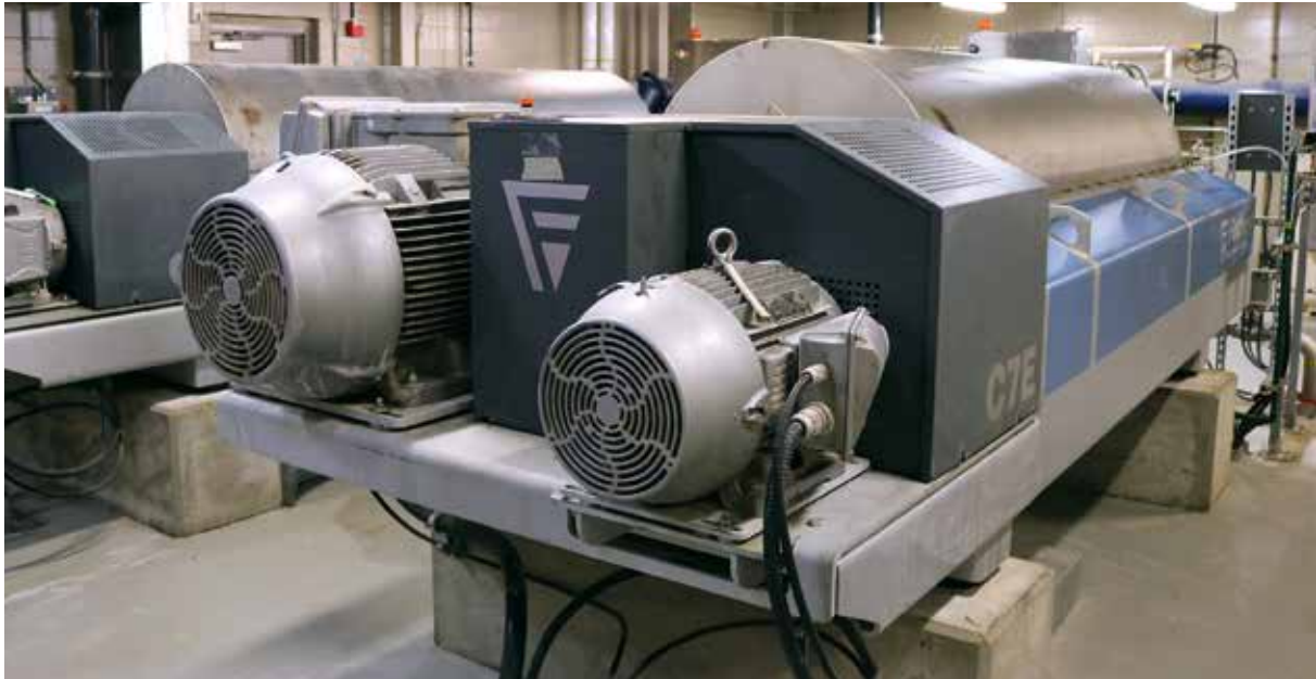
Die Kläranlage Greenway verwendet drei C7E Zentrifugen von Flottweg.
