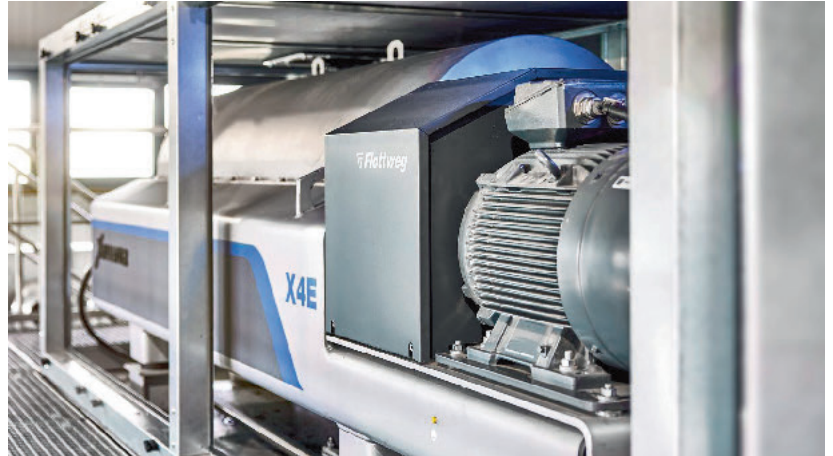
Zwei Xelletor X4E sind für die Schlammentwässerung in der Hauptkläranlage im Einsatz. Die beiden Dekanter sind mit Schallschutzhauben versehen, um die Arbeitsatmosphäre möglichst angenehm zu gestalten.
