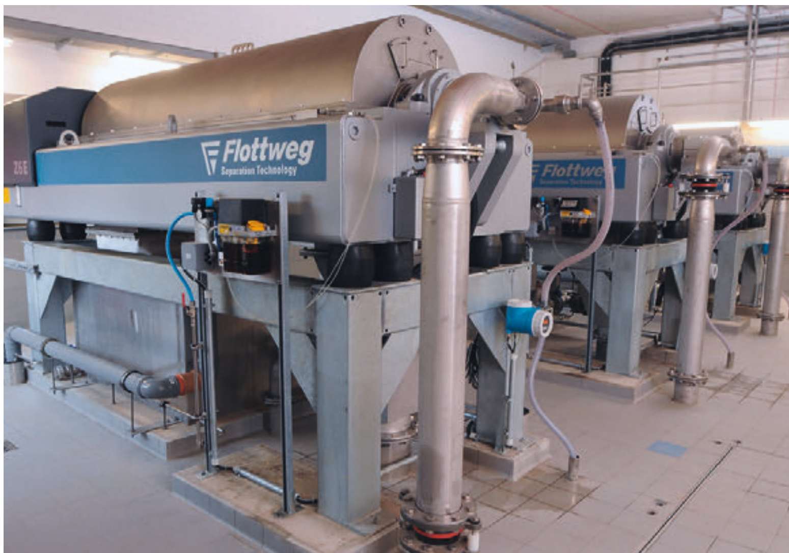
Abb.1 Klärschlamm-Eindickung als geschlossener Prozess: Dekanterzentrifugen im Einsatz.
