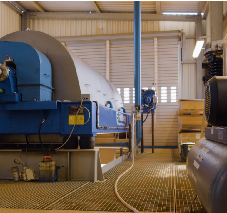
Die Dekanterzentrifuge Z92 von Flottweg verarbeitet bis zu 15 Tonnen des Materials pro Stunde.
