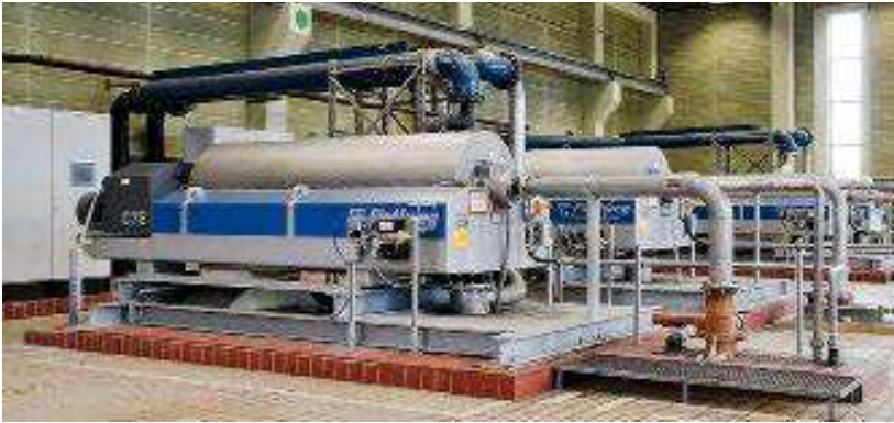
Beim Traditionsunternehmen Flottweg werden die Dekanter-Zentrifugen seit Ende 2016 mit dem fehlersicheren Basic Controller Simatic S7-1200 von Siemens ausgerüstet
