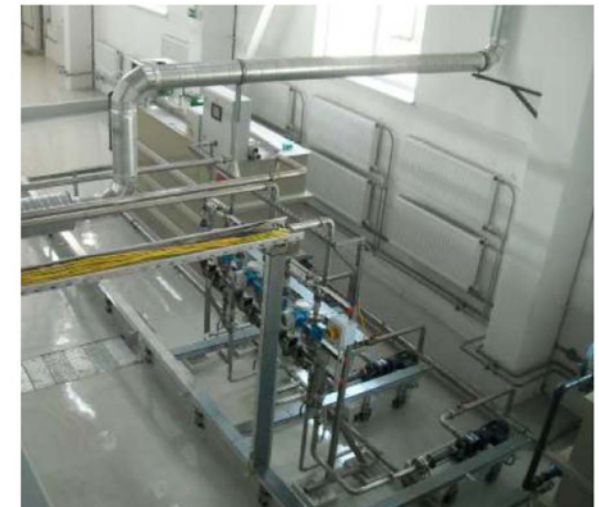
fig.: polymer dosing unit
