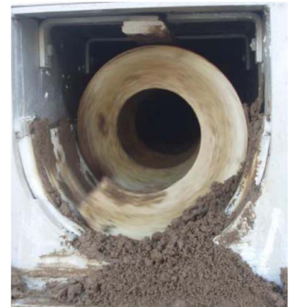
fig.: solids discharge
